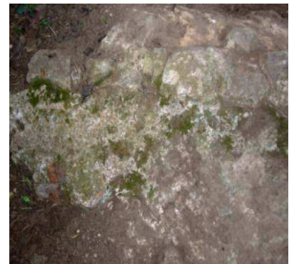
Fig. 4. 4 : Champignons envahissent la surface de l'aqueduc
