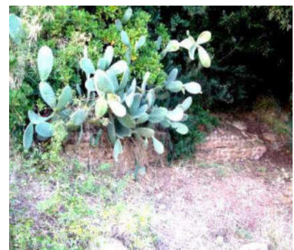
Fig. 4. 5 : Vue aqueduc envahi par une végétation diverses
