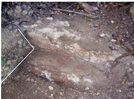
Fig. 4.10 : Etat de la cunette à Belhadjadj. Source : Auteurs
